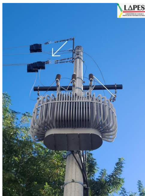
Fig. 8 Ocorrência de DPs em cobertura protetora em ancoragem de rede compacta.
