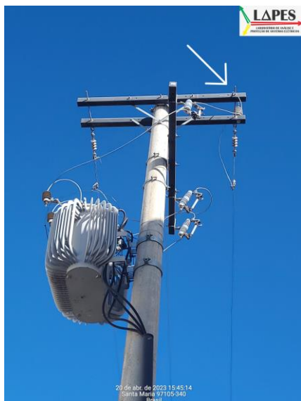
Fig. 6 Ocorrência de DPs em condutor sobre cruzeta em ancoragem de rede.
